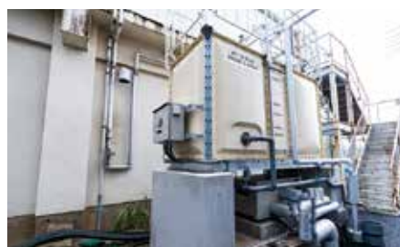
排水回収タンク （RO水精製工程排水をトイレ洗浄水として再利用） （埼玉事業所）
