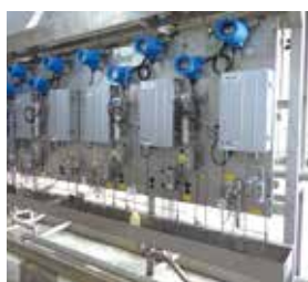
バイオマス発電所に設置された ボイラーサンプリング装置
