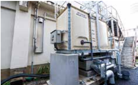
RO水精製時の排水タンク(トイレの洗浄水に再利用)(埼玉事業所)
