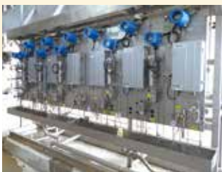
バイオマス発電所に設置されたボイラーサンプリング装置
